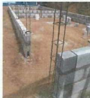
Foto 4: Se observa la falta el piso dentro de las dos aulas.
