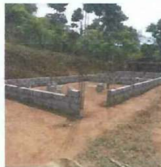
Foto 2: Se puede observar la falta de puertas.
