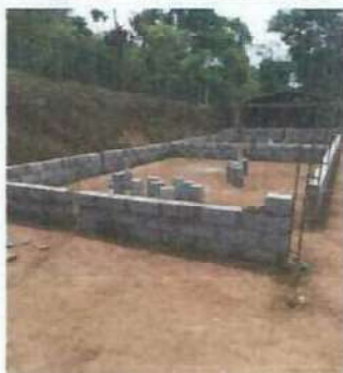
Foto 3: Se puede observar la falta de estructura de techo y cubierta de lamina
